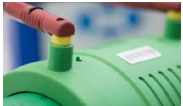
Esperar a que termine el proceso de soldadura (salida de los testigos)
